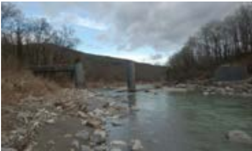
Ponte Cahen distrutto dalla alluvione del novembre 2012
